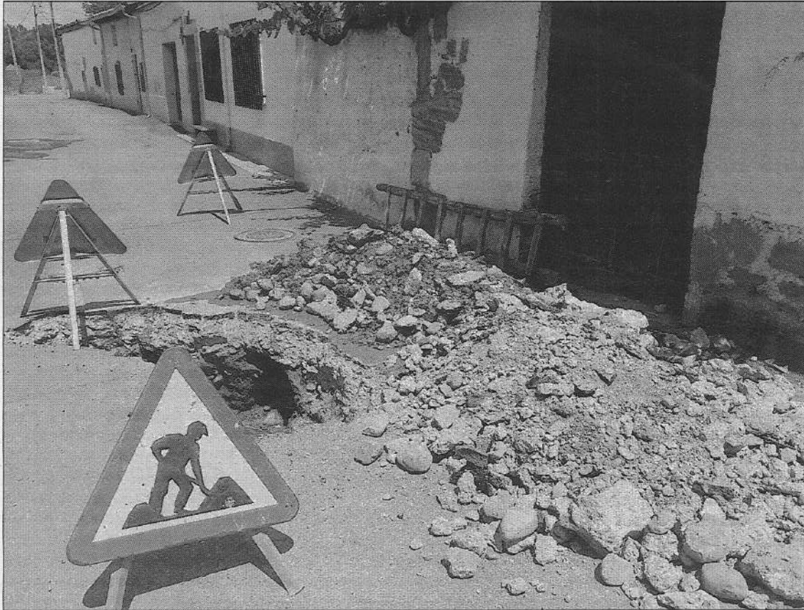
Punto de una calle de Olmo de la Guareña levantada para reparar la avería en la red de agua. | Foto L. O. Z.
